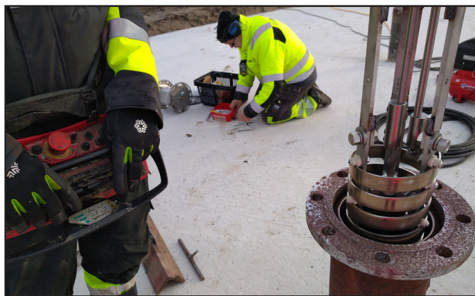
I vart och ett av borrhålen lyfts foderrör på plats. I dessa rör placeras sedan värmepolar (bilden), extraktionsutrustning och temperaturmätare.
